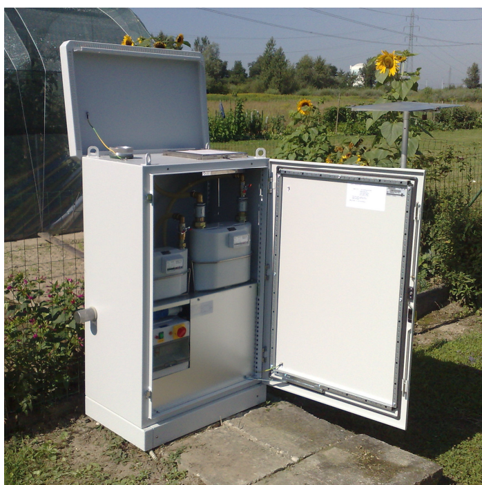
Slika 4.2: Kombinirana zračna črpalka IJS na lokaciji Spodnji Stari Grad. Gre za tipsko črpalko, ki je tudi na drugih lokacijah v okolici NEK. V letu 2015 je bilo izvedeno prvo ocenjevanje hrupa merilne naprave, ki jo je izvedlo podjetje Epi Spektrum varstvo okolja, informacijski sistemi in storitve, d. o. o. Na podlagi meritev hrupa in modelnega izračuna je bilo ocenjeno, da obremenitev s hrupom zaradi obratovanja vzorčevalnika zraka pri najbližjih stavbah z varovanimi prostori ne presega mejnih vrednosti za vir hrupa in mejnih koničnih vrednosti kazalcev hrupa za obrat ali napravo.
