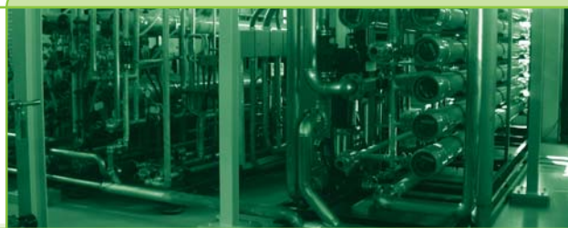
del sistema priprave demineralizirane vode - reverzna osmoza 9.1*
